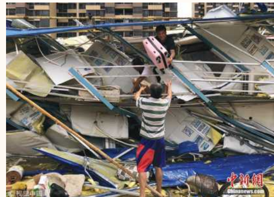
图22 珠海市金湾区红旗镇一工人宿舍被台风摧毁
